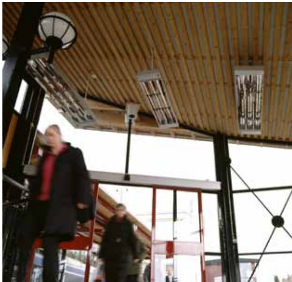
Dieser Vorort-Bahnhof von Stockholm wird mit IR-Wärmestrahlern beheizt. Ein Regler mit Zeitschalter erlaubt wartenden Fahrgästen die Temperatur zu erhöhen, wenn es besonders kalt ist.
