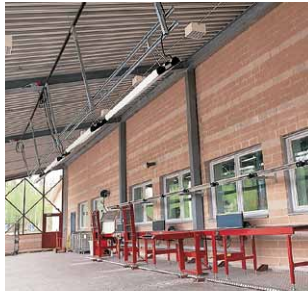
Der IR-Wärmestrahler kann in unterschiedlichen Winkeln montiert werden, um die Wärme dorthin zu richten, wo sie benötigt wird. Außenheizungen sollten unter dem Dach platziert werden. Bei dieser Installation werden die Arbeitsplätze von IR-Wärmestrahlern unter der Decke und CIR-Heizungen an der Wand beheizt.
